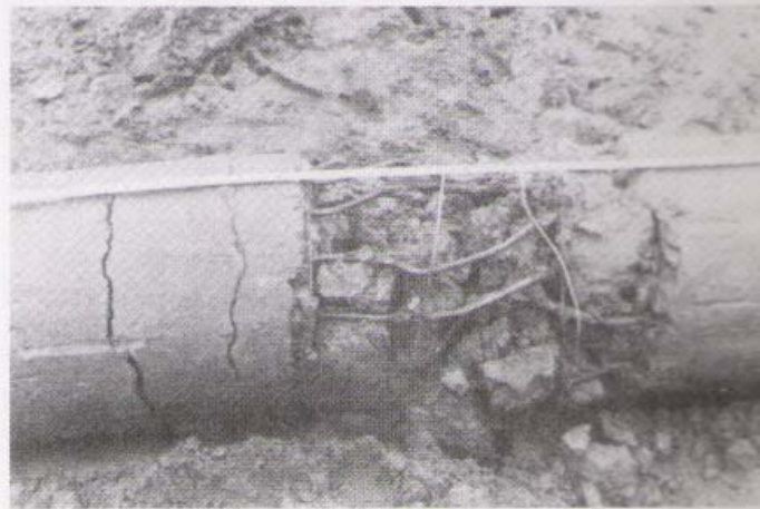
Fig. 3. Danni riportati dal palo
