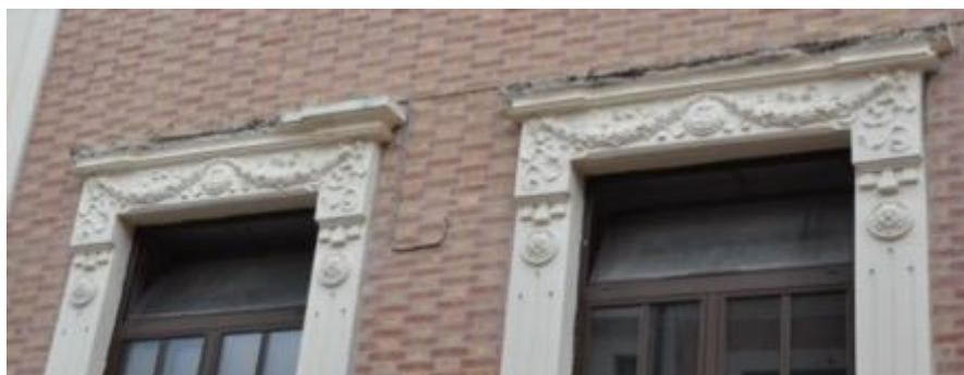
Figura 1.25: Cornicione superiore delle finestre con espulsione del copriferro
