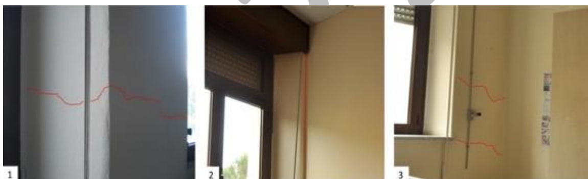
Figura 1.46: Identificazione del quadro fessurativo
