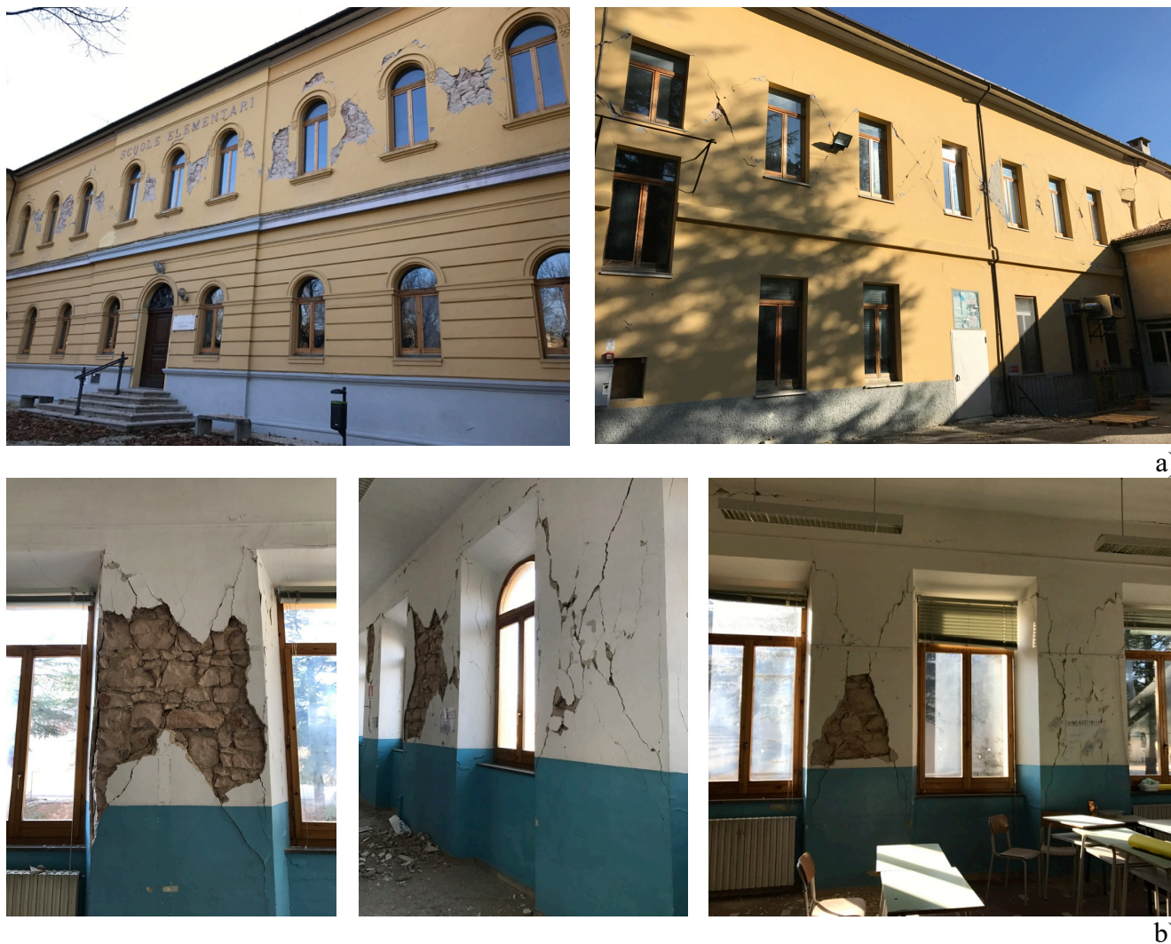
Figura 11. Meccanismi di danno nel piano nei maschi dei due prospetti lunghi: viste esterne (a) e interne (b)
