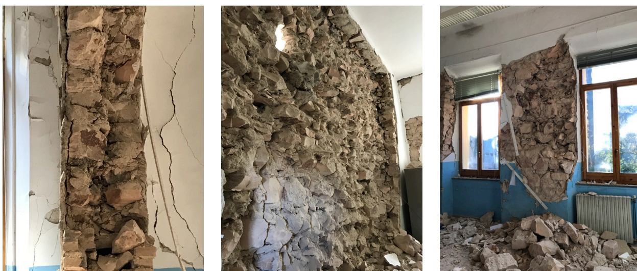
Figura 5. Dettagli relativi alla sezione trasversale dei pannelli murari ed esempi di crolli di uno dei paramenti murari
