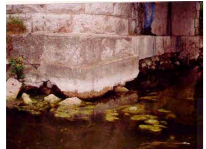
Scavo localizzato alla base della pila
