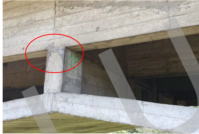
Fessurazione connessione elementi verticali
