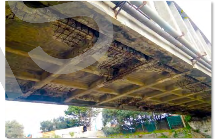
Lesioni connessione traverso/catena
