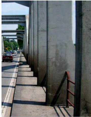
Degrado dei pendini
