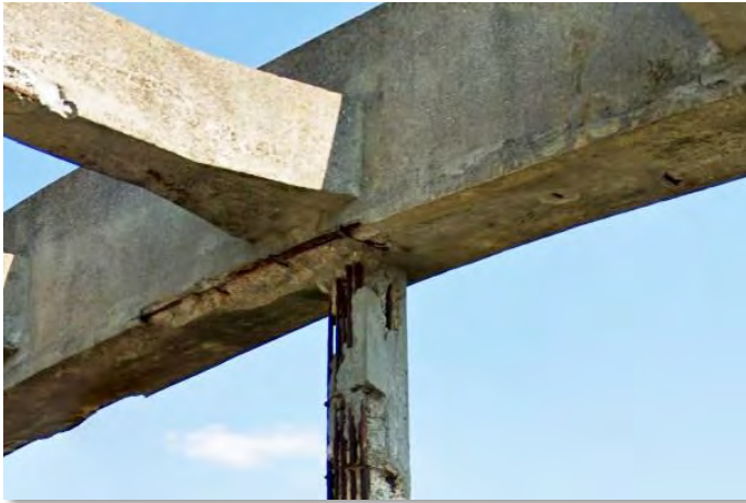
Degrado connessione pendini
