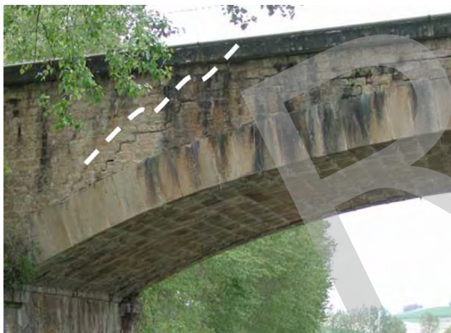
Fessura diagonale del timpano
