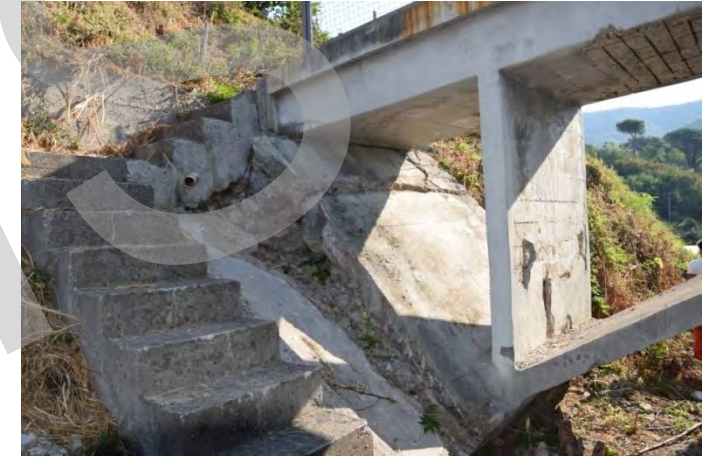
Problemi alla fondazione
