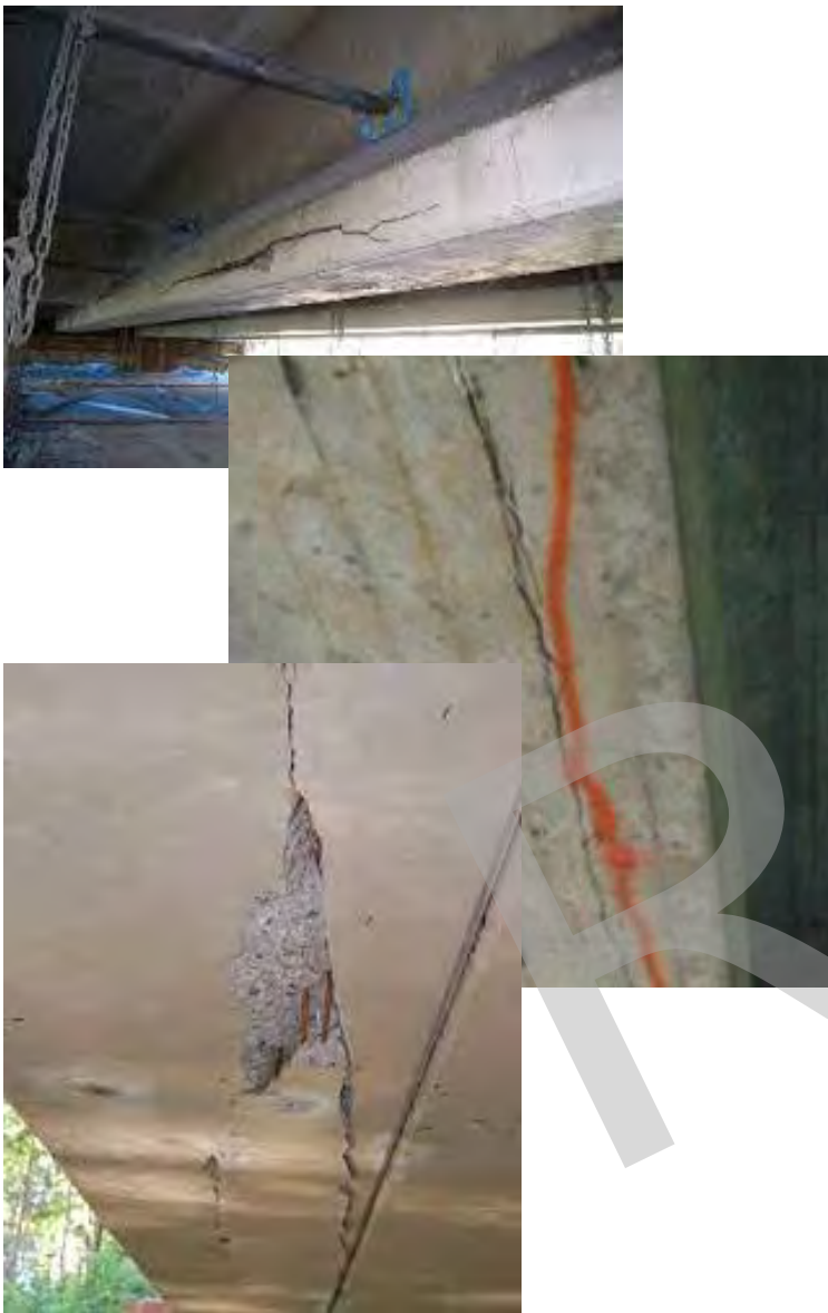
Lesioni lungo suola del bulbo
