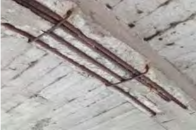
Distacco del copriferro
