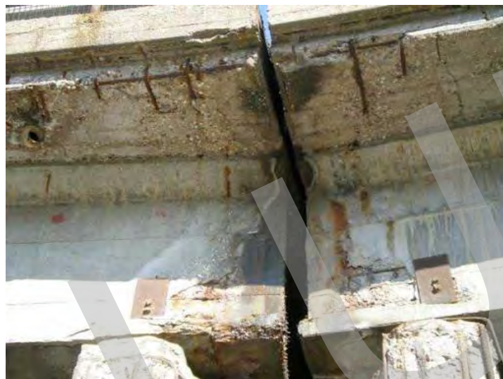
Cls dilavato/ammalorato testate
