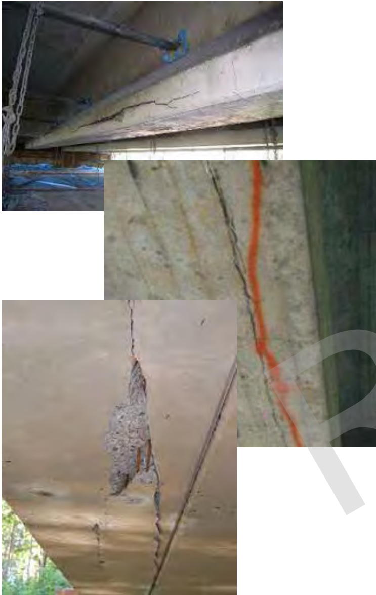
Lesioni lungo suola del bulbo
