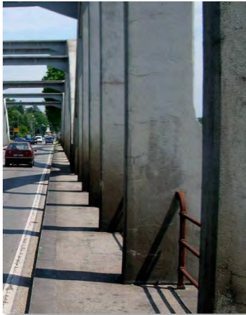
Degrado dei pendini
