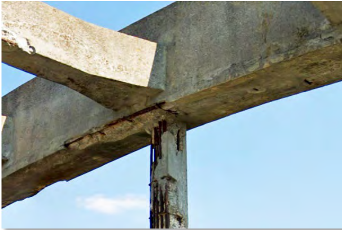
Degrado connessione pendini
