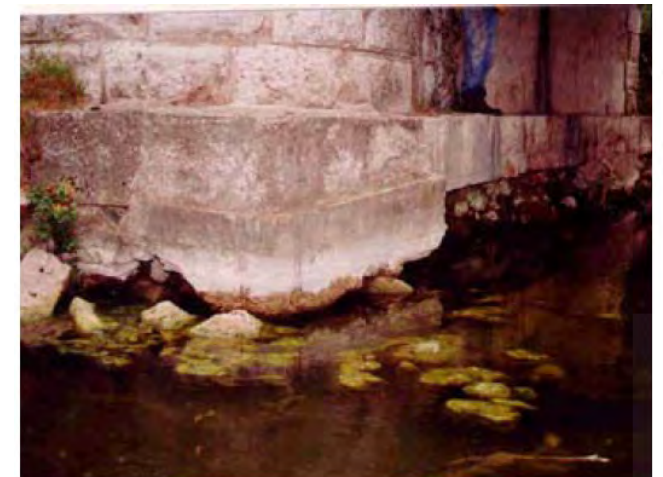
Scavo localizzato alla base della pila
