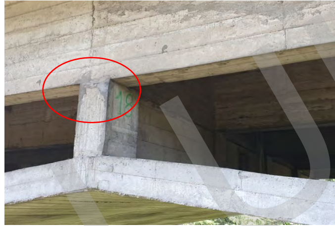
Fessurazione connessione elementi verticali
