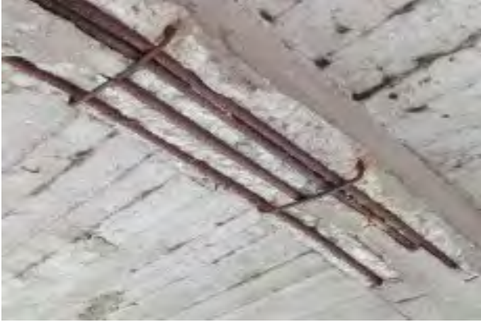
Distacco del copriferro
