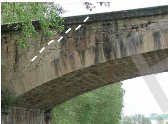
Fessura diagonale del timpano
