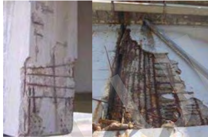
Armatura scoperta/ossidata testate
