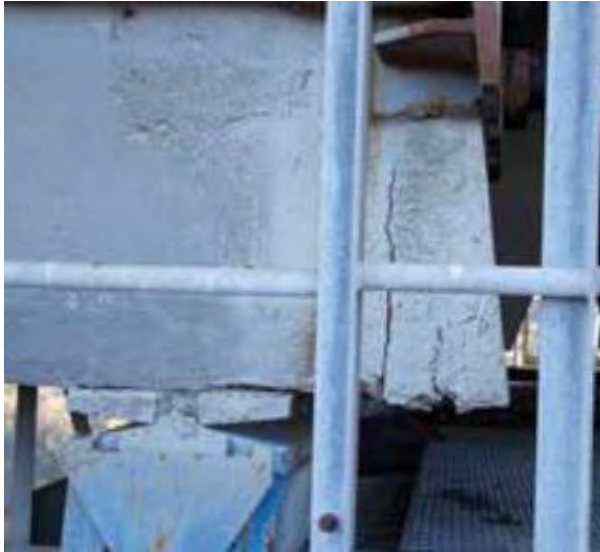
Distacco tamponi testate
