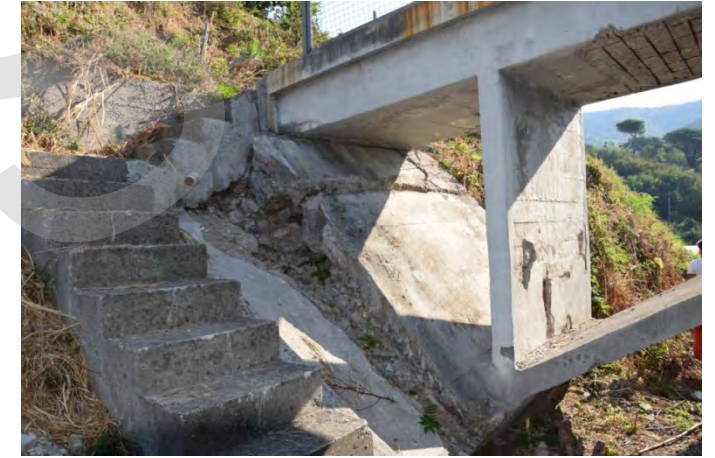
Problemi alla fondazione
