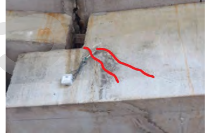
Fessure diagonali in corrispondenza delle selle
