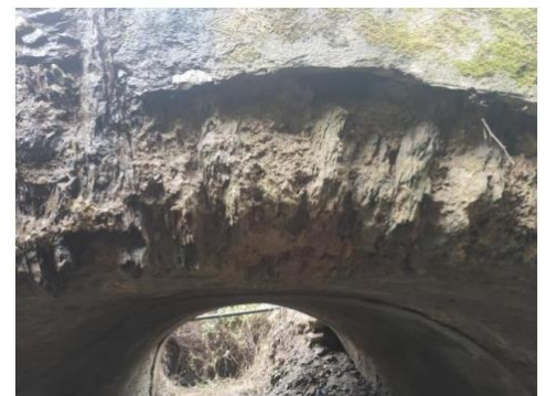
A-C1.1_Mur_4_2: Porzione di muratura mancante.
