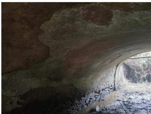
A-C1.1_Mur_9_1: Macchie di umidità/risalita.
