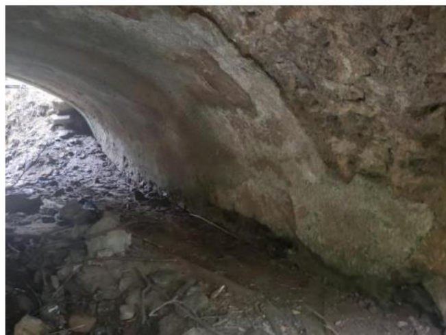
S1_Mur_9_1: Macchie di umidità/risalita.
