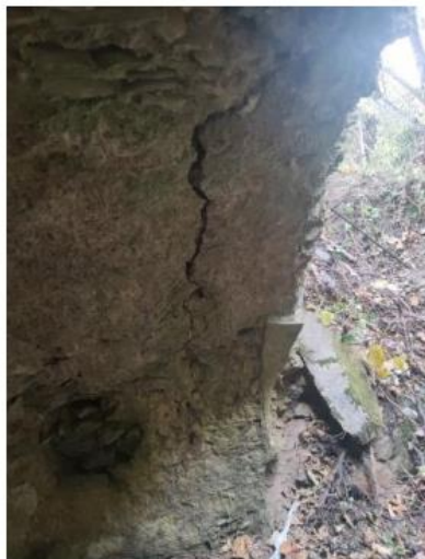
A-C1.1_Mur_6_1: Fessure longitudinali.
