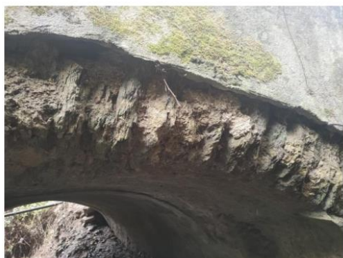
A-C1.1_Mur_4_1: Porzione di muratura mancante.
