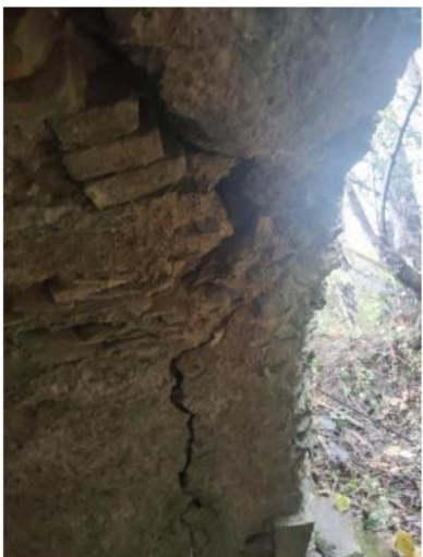
A-C1.1_Mur_6_2: Fessure longitudinali.
