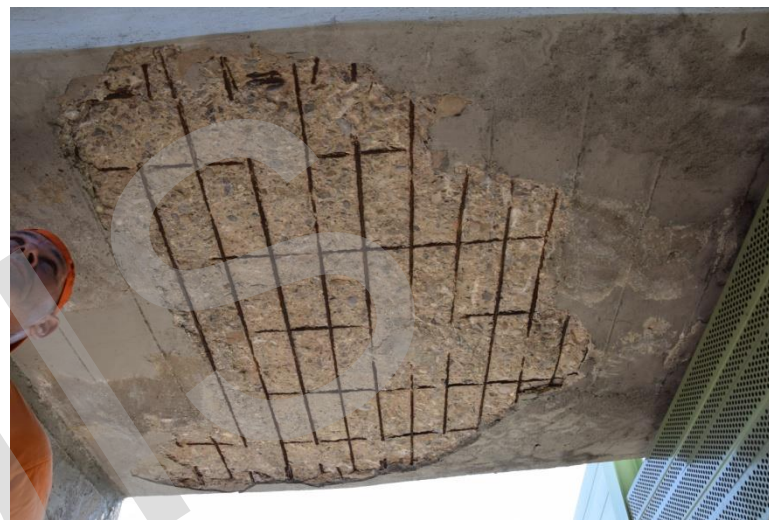
estesa corrosione dell'armatura dell'arco
