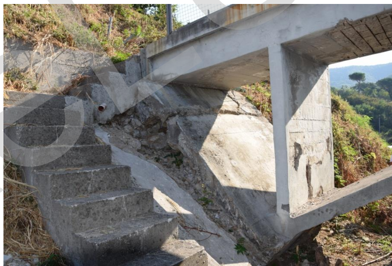
Problemi di fondazione
