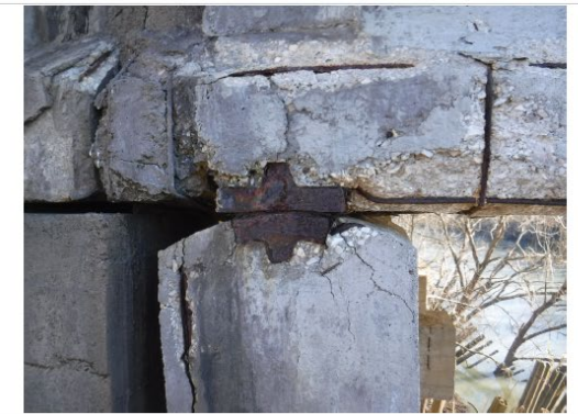
Foto 2 - Doppio pendolo lato Nord fortemente degradato e fuori piombo
