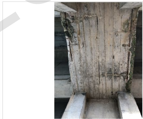
Foto 4 - Distacchi localizzati del copriferro con barre di armatura ossidate
