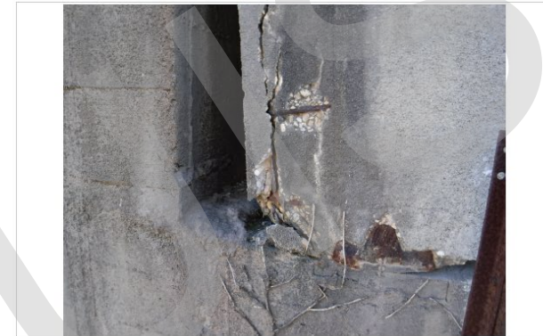
Foto 1 - Doppio pendolo lato Nord fortemente degradato e fuori piombo 4-5cm
