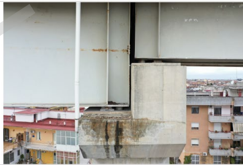
Foto 4 - Tracce di scolo - Cls dilavato - Macchie di umidità - Staffe scoperte
