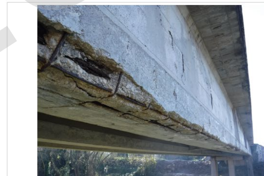
Foto 3 - Vista travi - COPRIFERRO DISTACCATO - OSSIDAZIONE
