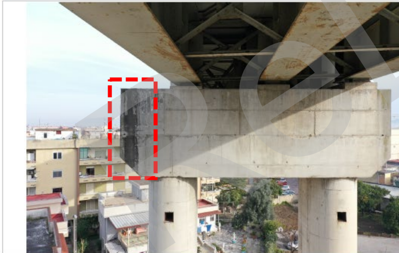
Foto 3 - Tracce di scolo - CIs dilavato
