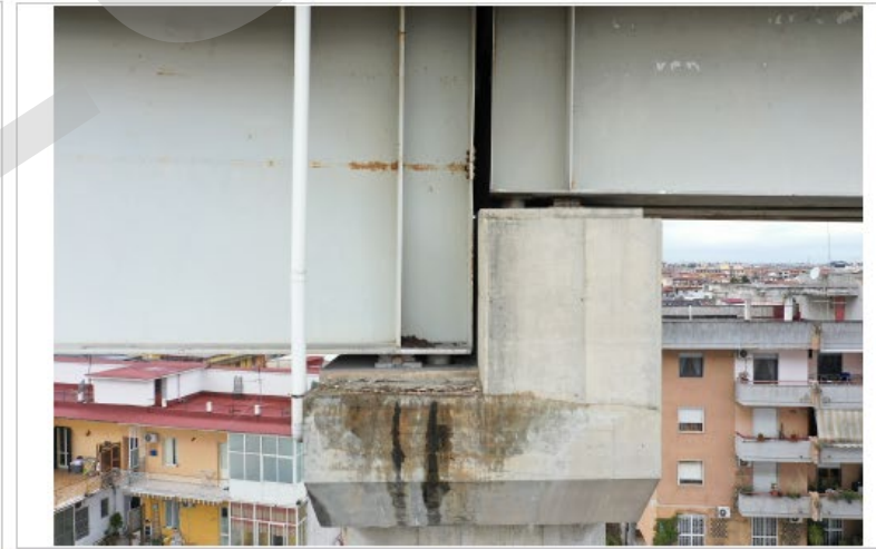
Foto 4 - Tracce di scolo - Cls dilavato - Macchie di umidità - Staffe scoperte
