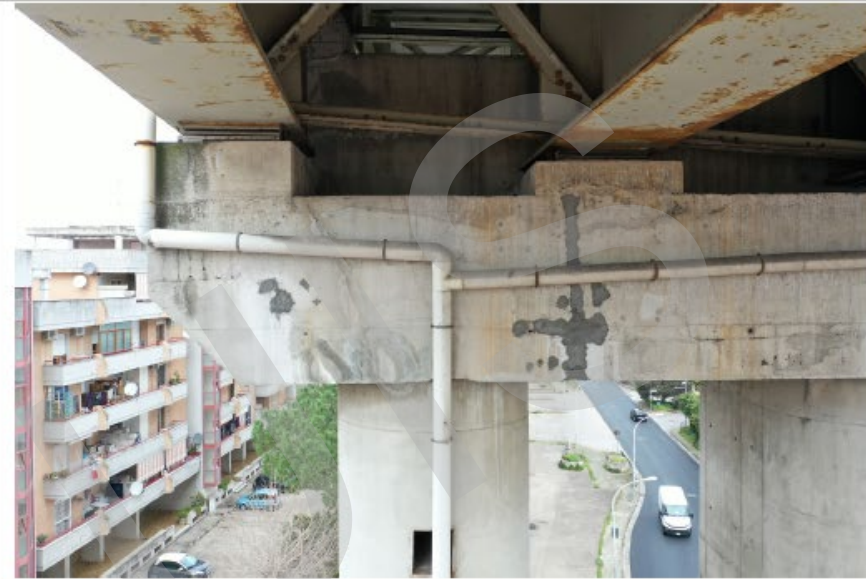
Foto 2 - Lesioni in corrispondenza staffe - fessure diagonali
