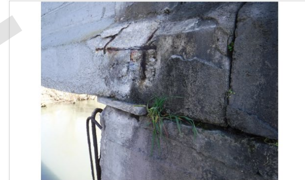
Foto 3 - Appoggio dislocato su pila Sud
