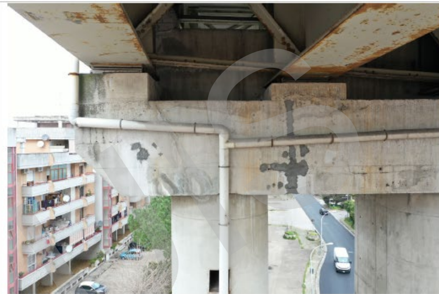
Foto 2 - Lesioni in corrispondenza staffe - fessure diagonali
