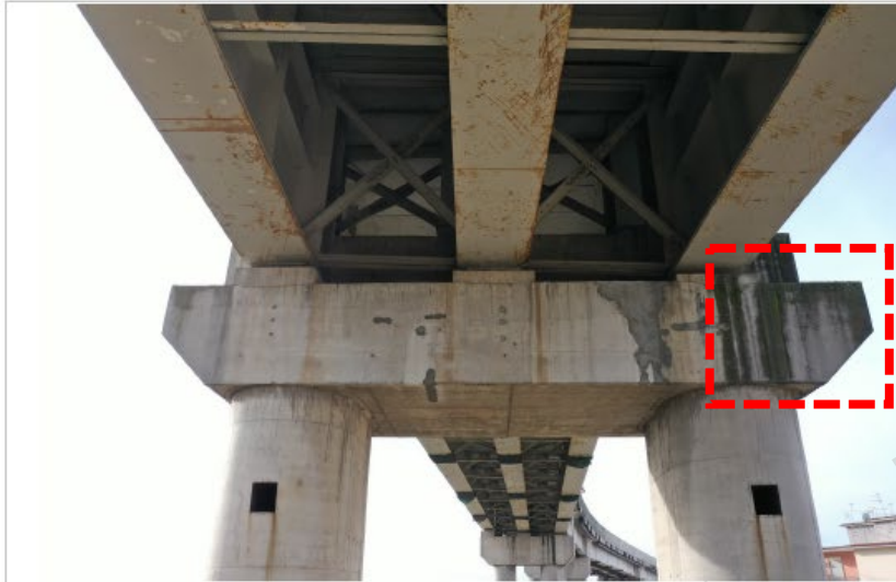
Foto 1 - Tracce di scolo - CIs dilavato - Macchie di umidità
