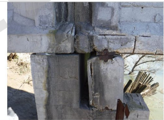
Foto 4 - Doppio pendolo lato Nord fortemente degradato e fuori piombo
