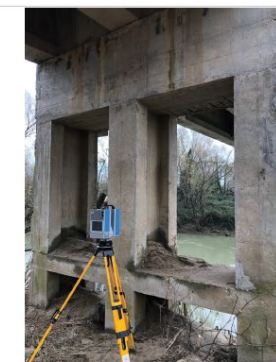
Foto 2 - Percolazioni con tracce di scolo e ammaloramenti
