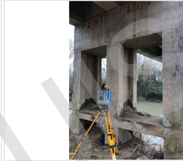
Foto 2 - Percolazioni con tracce di scolo e ammaloramenti
