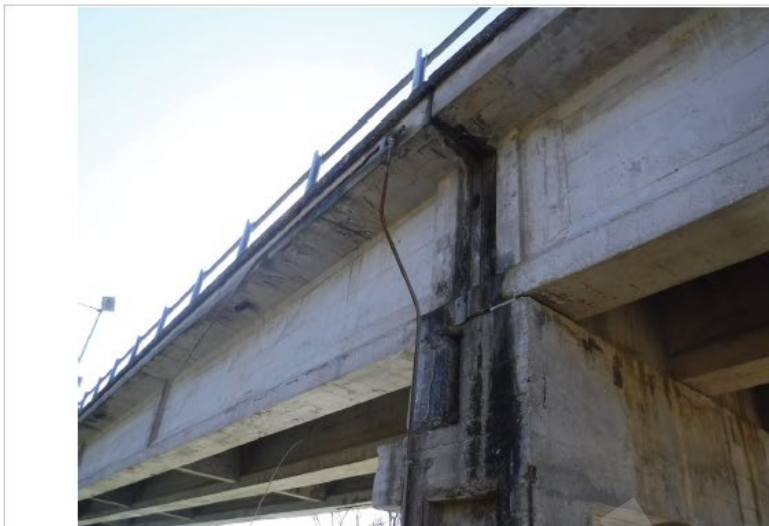
Foto 1 - Percolazioni con tracce di scolo e ammaloramenti
