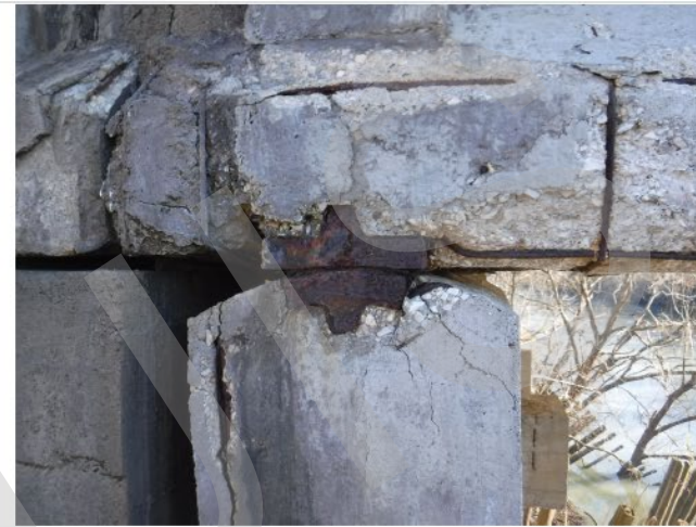
Foto 2 - Doppio pendolo lato Nord fortemente degradato e fuori piombo
