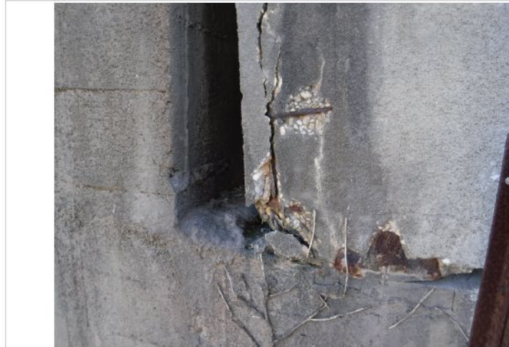
Foto 1 - Doppio pendolo lato Nord fortemente degradato e fuori piombo 4-5cm
