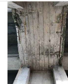
Foto 4 - Distacchi localizzati del copriferro con barre di armatura ossidate
