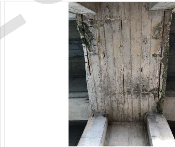
Foto 4 - Distacchi localizzati del copriferro con barre di armatura ossidate
