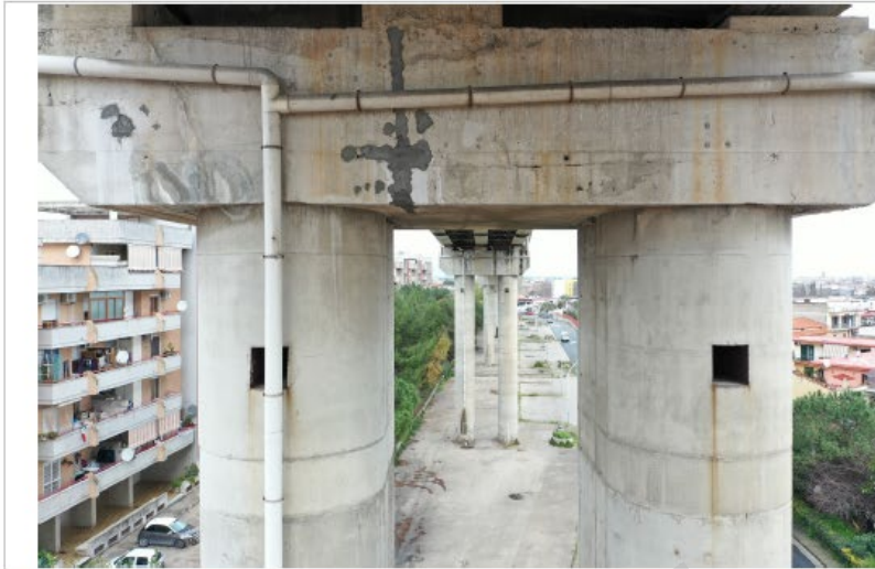
Foto 1 - Tracce di scolo - Cls dilavato - Macchie di umidità
