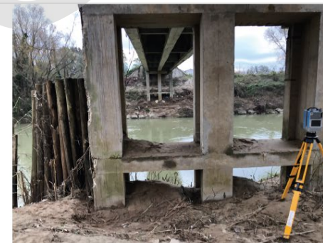
Foto 3 - Distacchi localizzati del copriferro con barre di armatura ossidate
