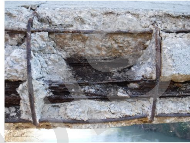
Foto 2 - Vista travi - FILI SPEZZATI
