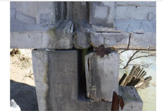
Foto 4 - Doppio pendolo lato Nord fortemente degradato e fuori piombo
