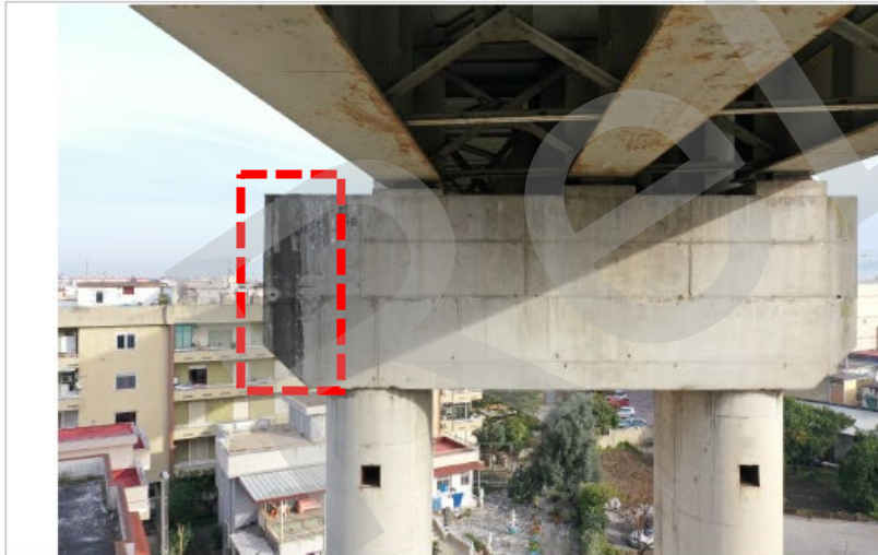
Foto 3 - Tracce di scolo - CIs dilavato
