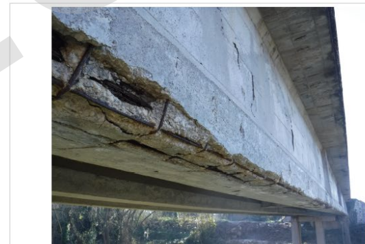
Foto 3 - Vista travi - COPRIFERRO DISTACCATO - OSSIDAZIONE
