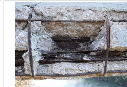
Foto 2 - Vista travi - FILI SPEZZATI
