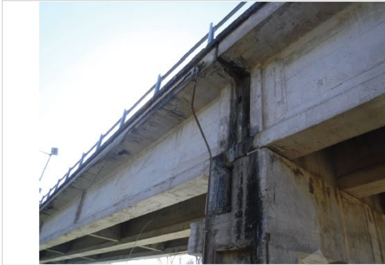
Foto 1 - Percolazioni con tracce di scolo e ammaloramenti
