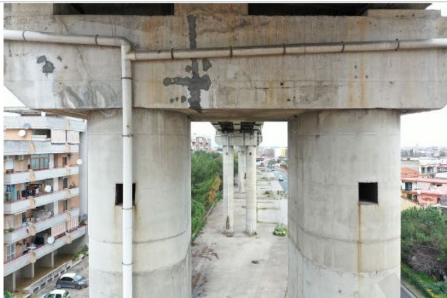
Foto 1 - Tracce di scolo - Cls dilavato - Macchie di umidità
