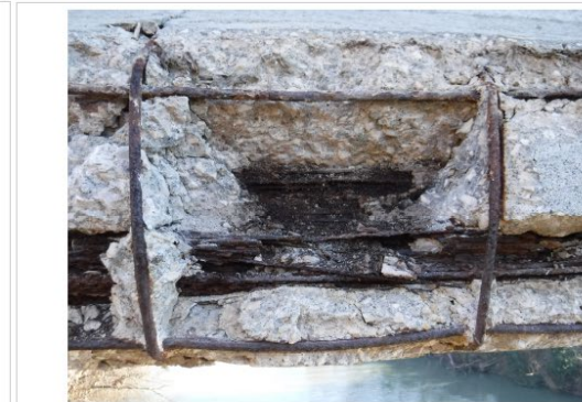
Foto 2 - Vista travi - FILI SPEZZATI
