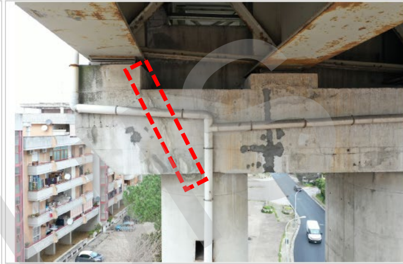
Foto 2 - Lesioni in corrispondenza staffe - fessure diagonali
