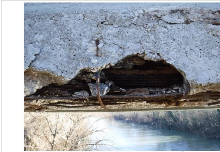
Foto 1 - Vista travi - OSSIDAZIONE - ARMATURA LONG. DEFORMATA
