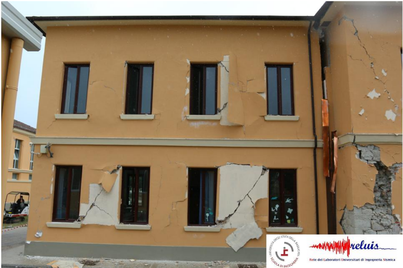
Giunto tra uno dei corpi in c.a. ed il corpo in muratura. Danneggiamento di maschi murari del corpo in muratura (destra) Danneggiamento di tamponature del corpo in c.a. (sinistra)
