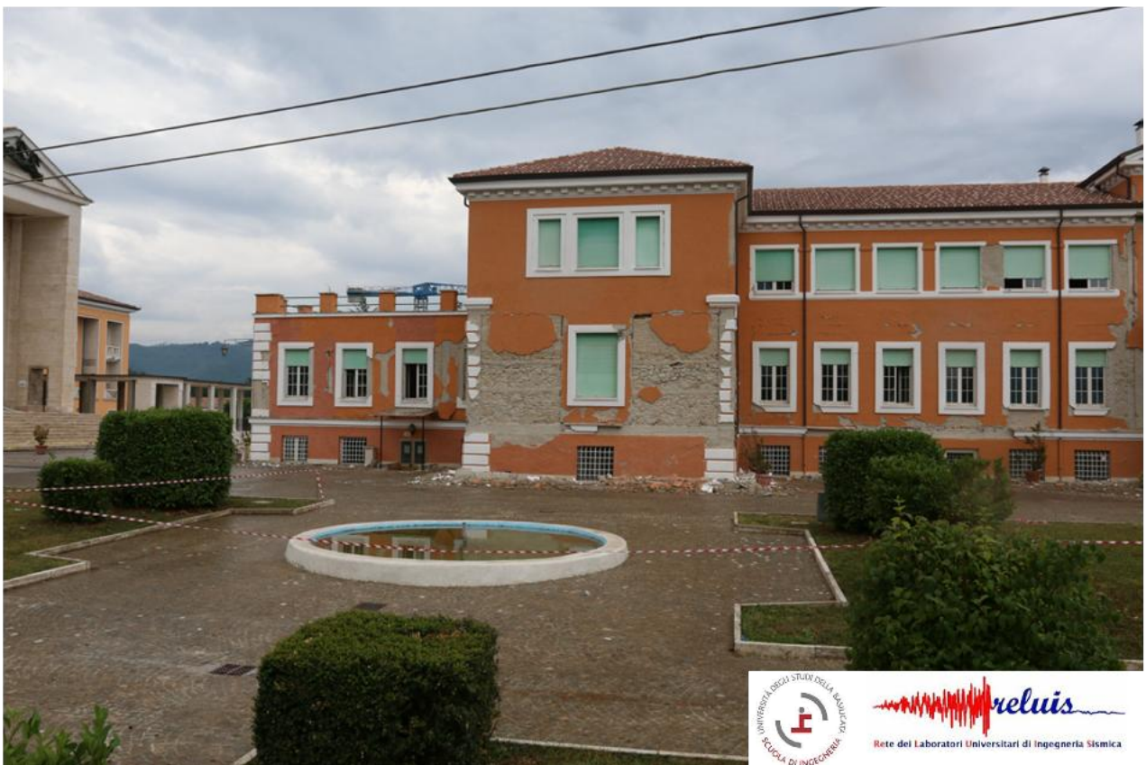
Distacco intonaci e danneggiamento maschi murari con distacco dalla maglia in c.a.
