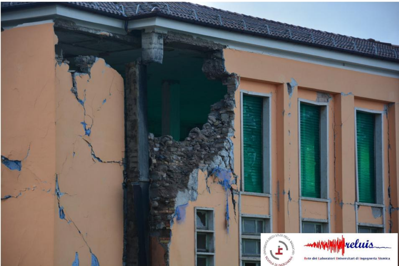
Crollo parziale di una parete
