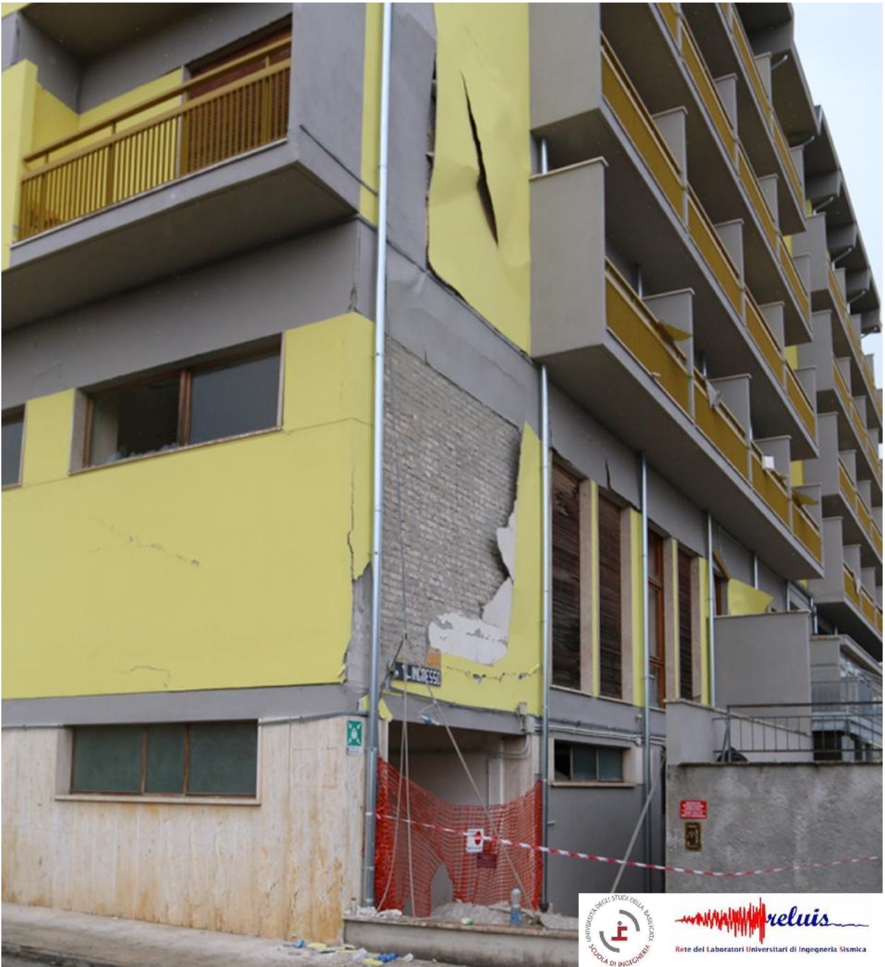
Lieve danneggiamento agli elementi non strutturali con distacchi di intonaco
