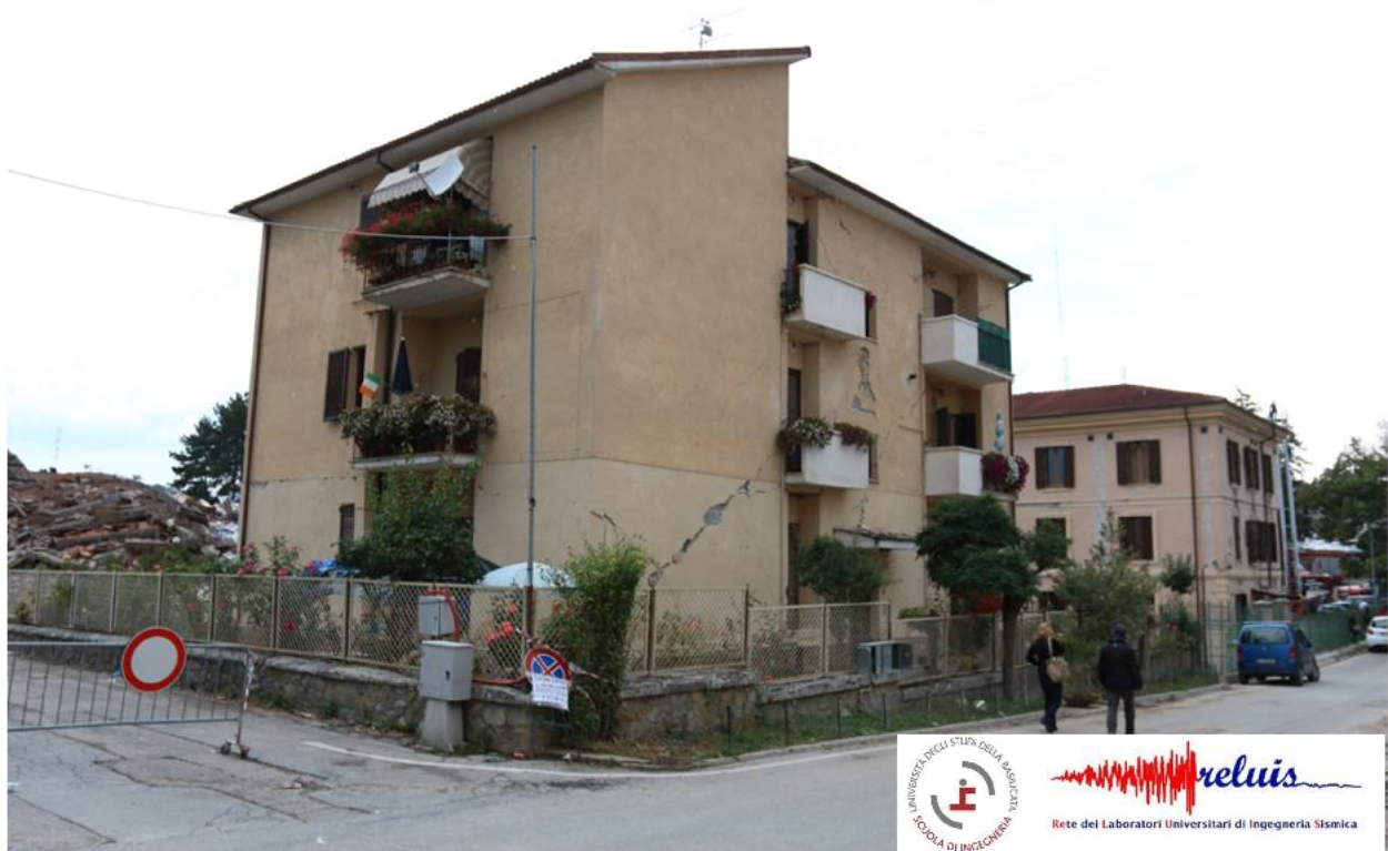
Danneggiamento nel piano di alcuni maschi murari
