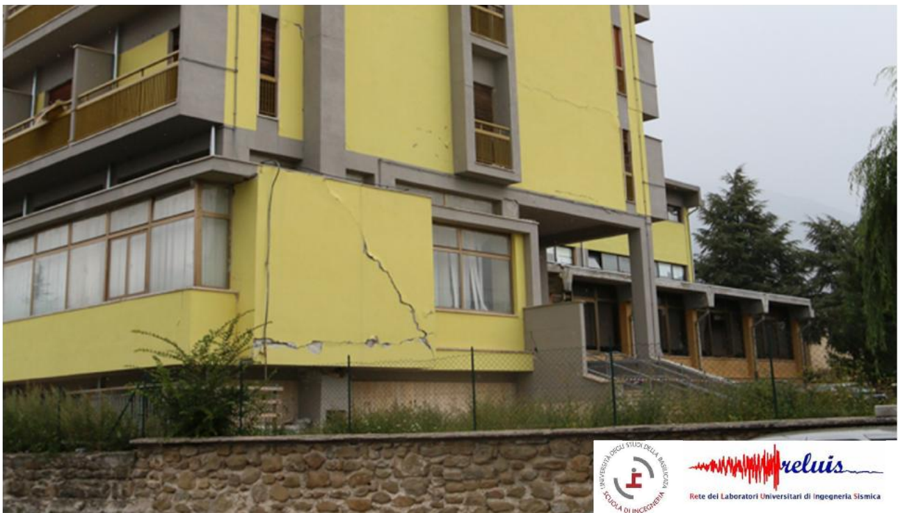
Danno alle tamponature
