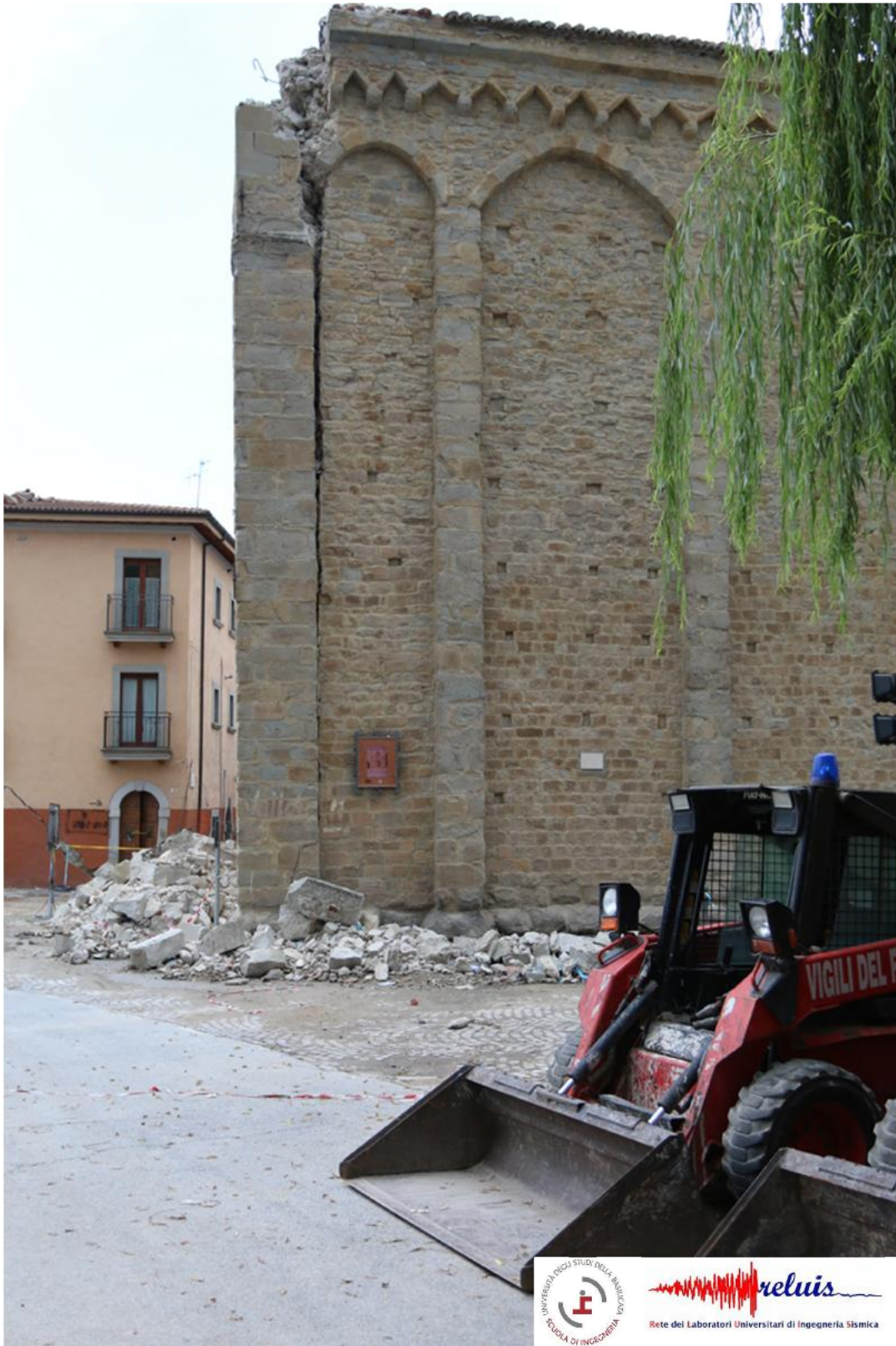
Distacco della facciata
