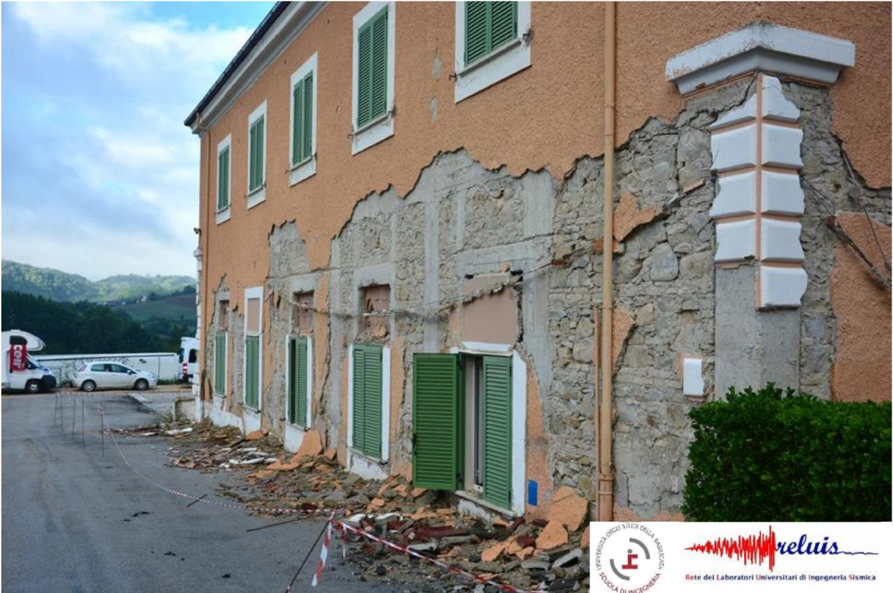
Distacco dell'intonaco e danno alle murature
