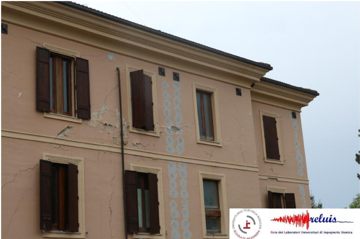
Dettaglio del danneggiamento
