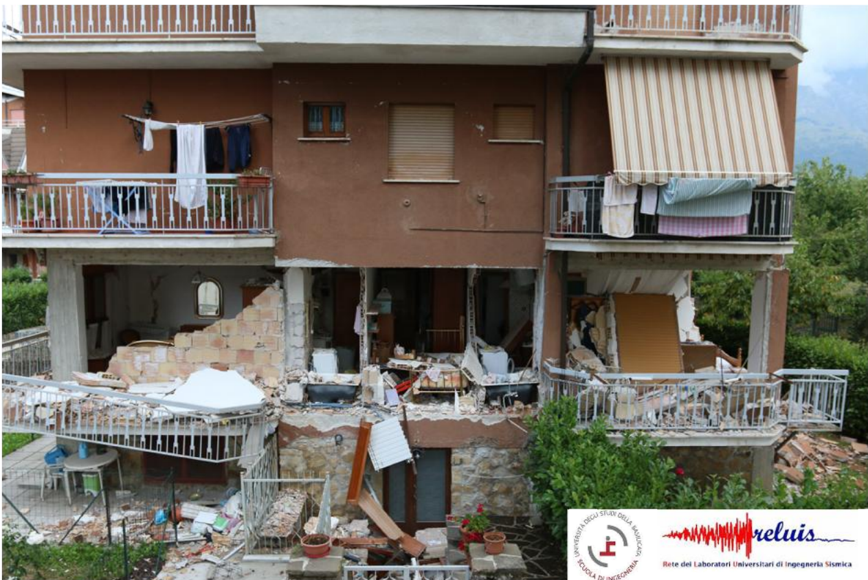
Danneggiamento diffuso alle tamponature del I e II livello
