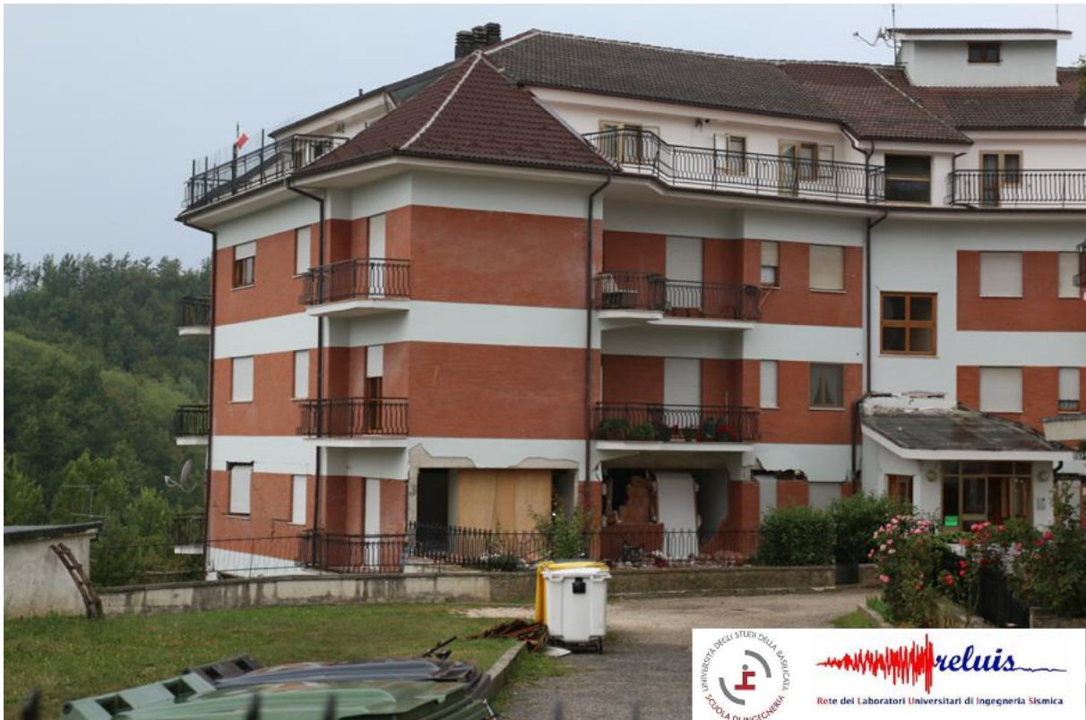
Danno alle tamponature
