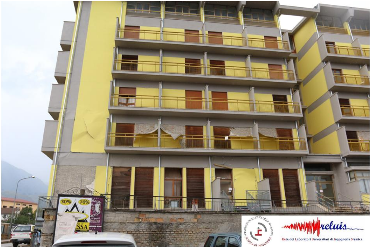
Distacchi di intonaco
