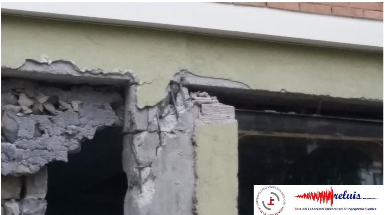
Danno per sollecitazioni taglienti alla testa del pilastro
