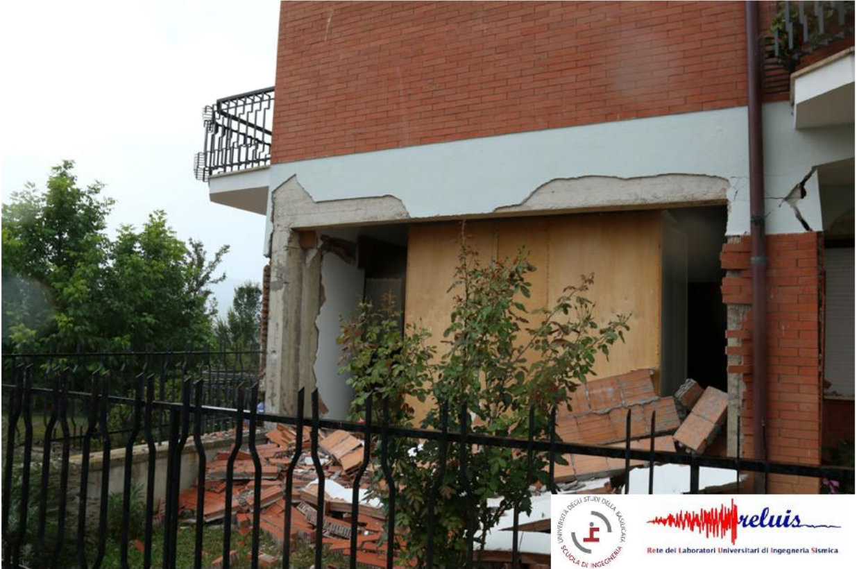
Danno alle tamponature
