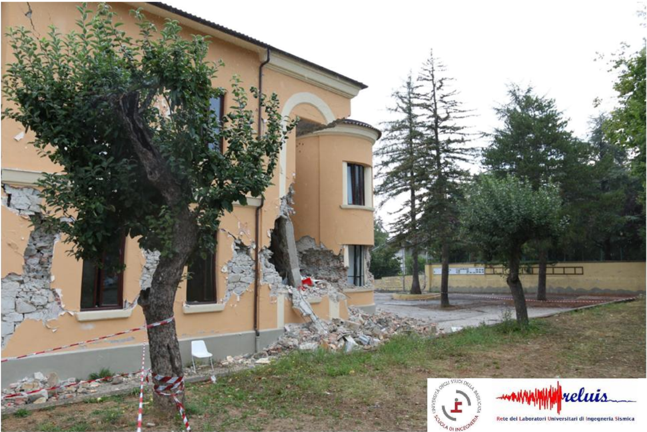
Danneggiamento del corpo in muratura
