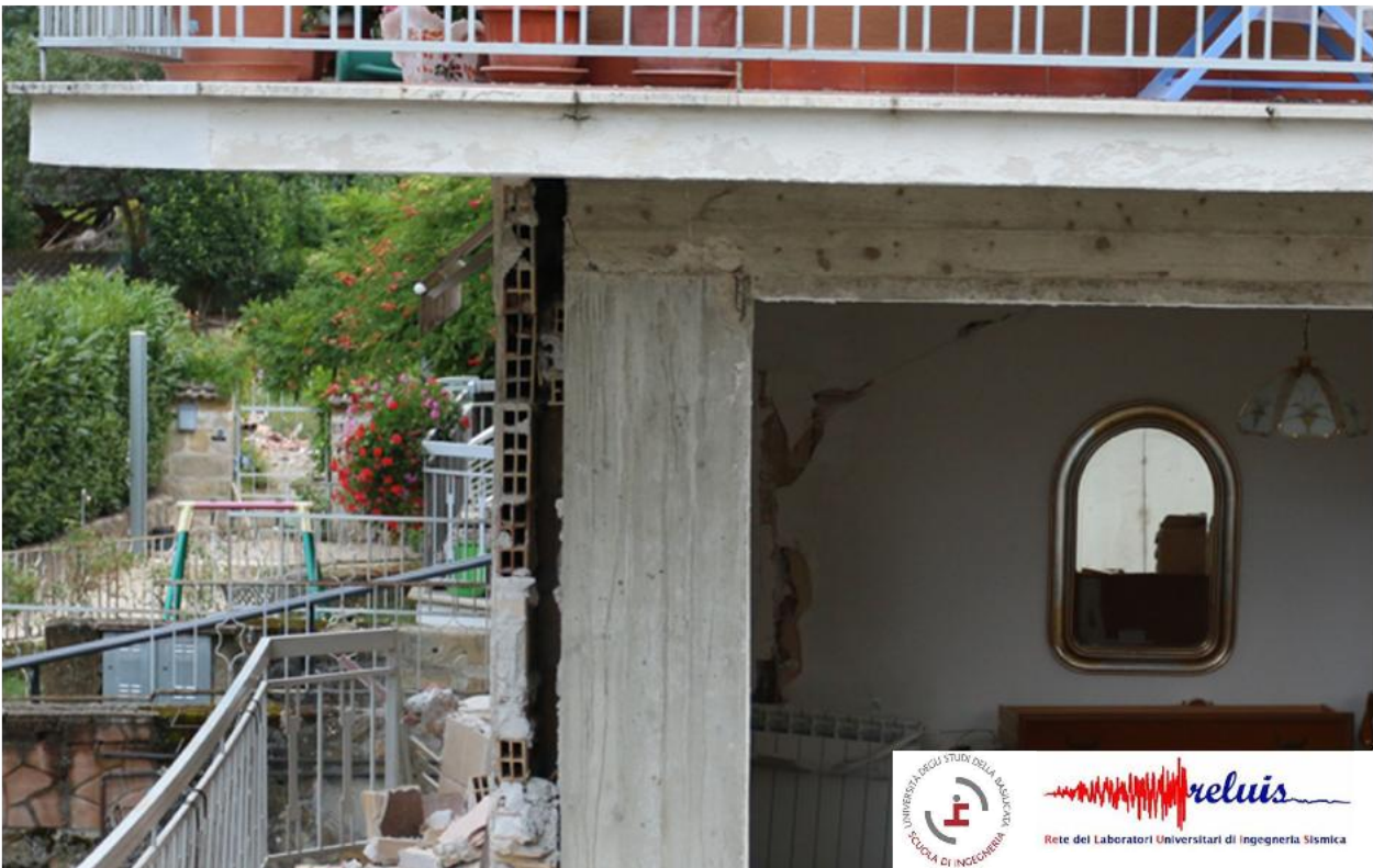
Fodera di tamponatura completamente esterna alla maglia strutturale - Danno al nodo trave-pilastro
