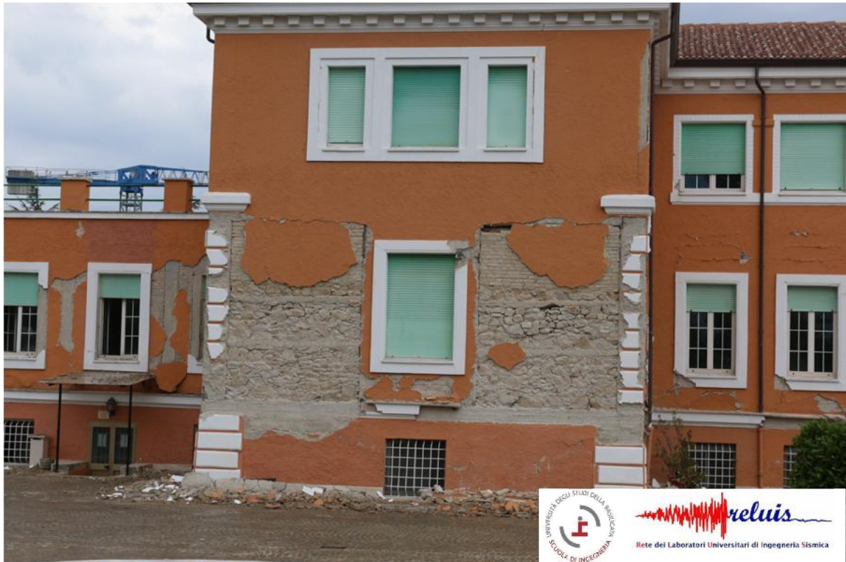
Distacco intonaci e danneggiamento maschi murari con distacco dalla maglia in c.a.
