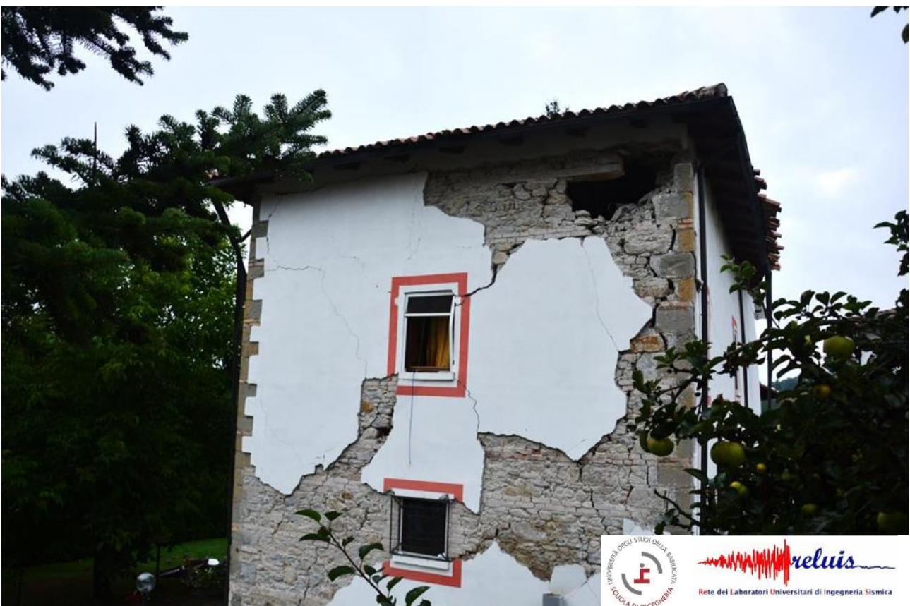
Danneggiamento diffuso di una facciata
