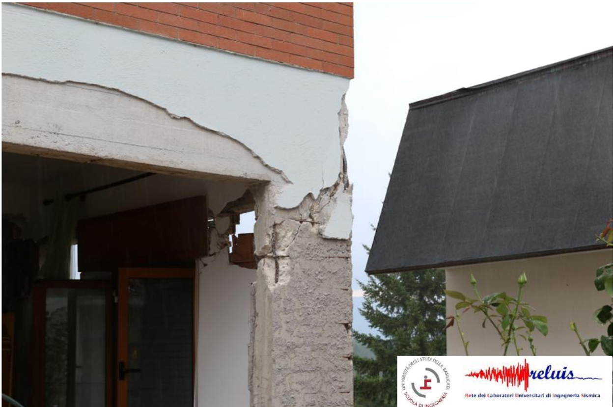
Particolare del danno ad un nodo trave-pilastro
