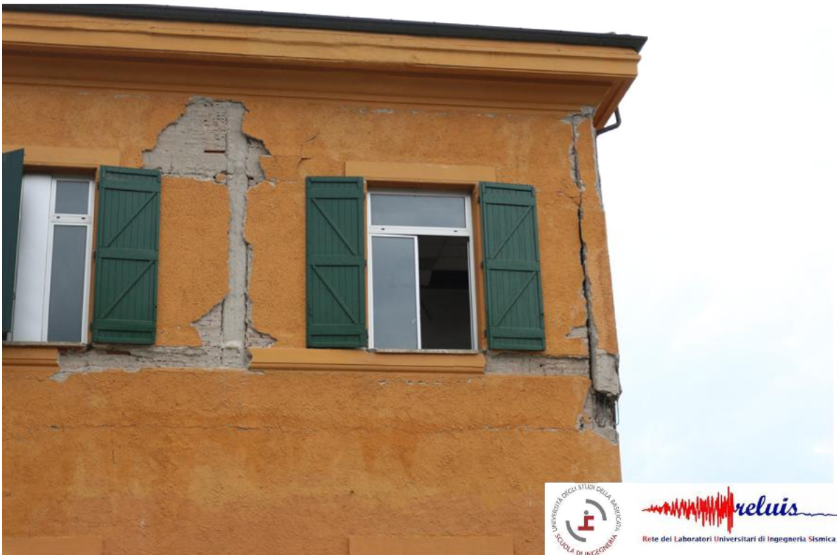
Rottura del nodo pilastro-cordolo di piano
