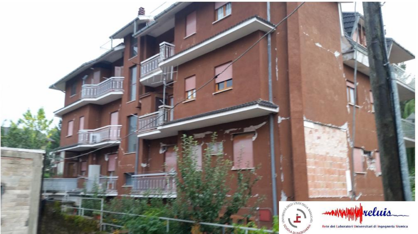
Danno alle tamponature
