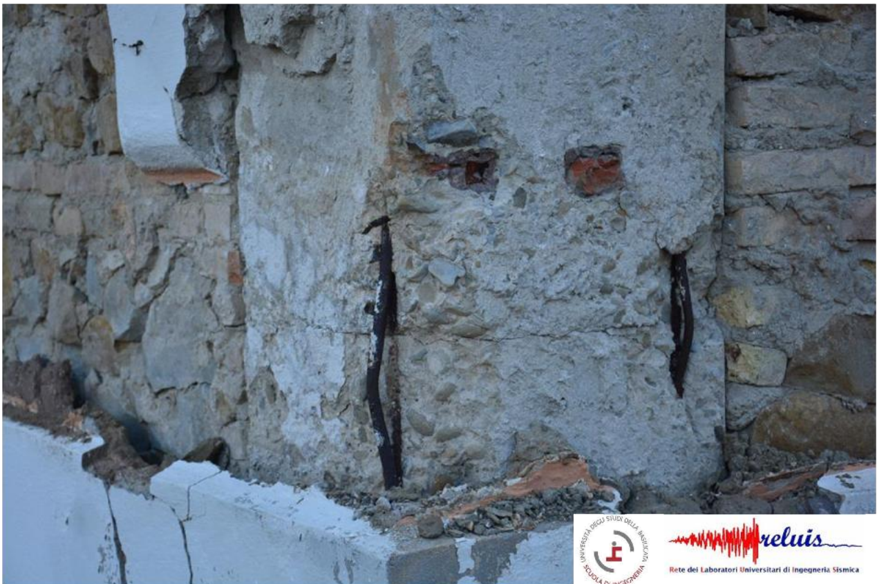
Dettaglio dei ferri di un pilastro instabilizzati
