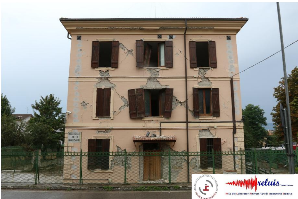
Danneggiamento nel piano di maschi murari e di fasce di piano
