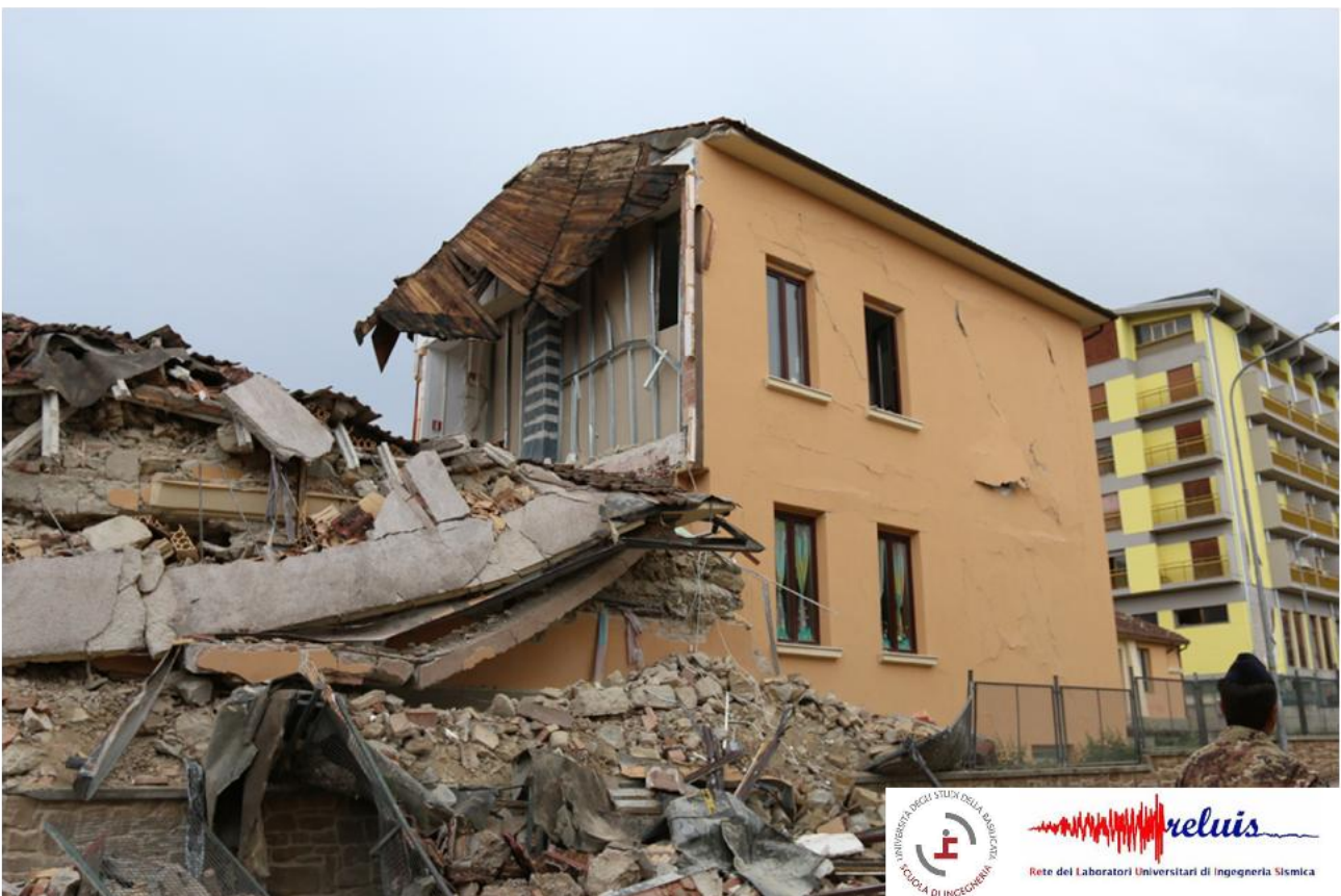
Distacco di intonaci e danneggiamento delle tamponature in uno dei corpi in c.a.
