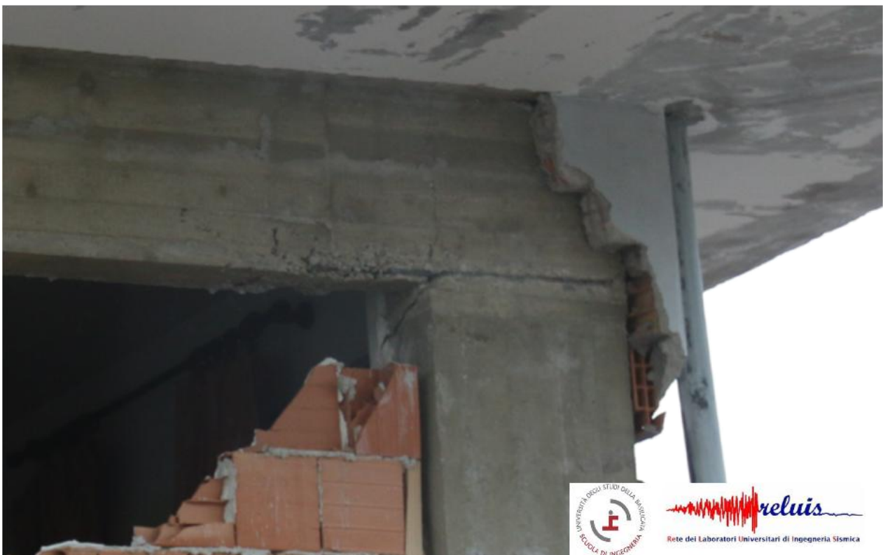
Danno al nodo trave-pilastro, fodera di tamponatura completamente esterna alla maglia strutturale
