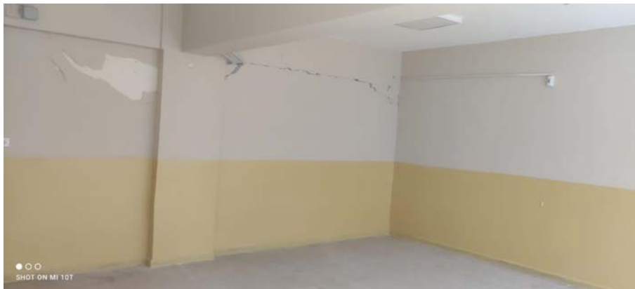
Fig. 4 Foto del danneggiamento rilevato nella zona di interfaccia tra il telaio originario in c.a. e il setto adottato come sistema di rinforzo
