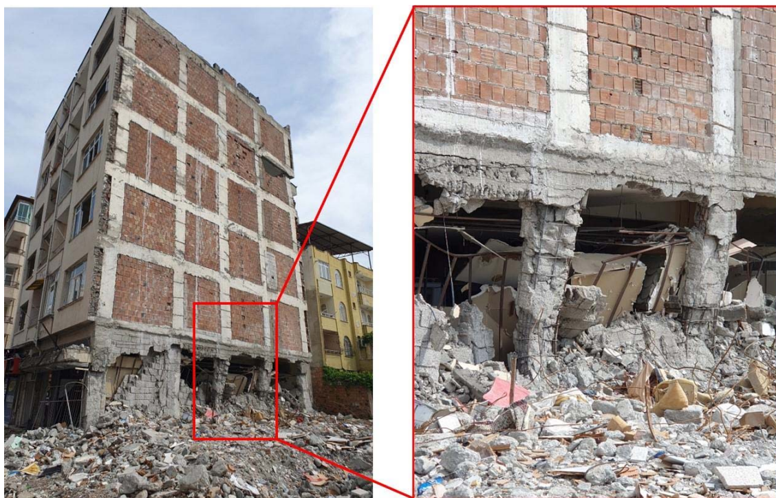
Fig. 6 Foto del danneggiamento dovuto allo sviluppo di un meccanico di piano soffice di un edificio in c.a.
