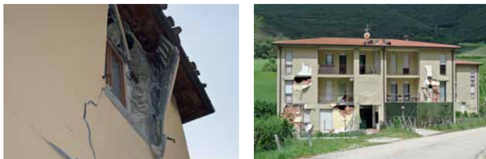
Figura 1.1. Danni provocati dal terremoto del Centro Italia del 2016 a sistemi di isolamento termico installati su edifici esistenti.
