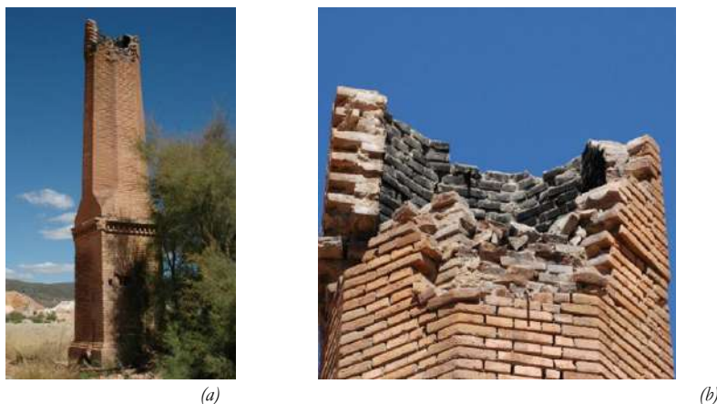
Figura 8-23 – (a) Ciminiera crollata a seguito di forti raffiche di vento; (b) ingrandimento della parte danneggiata (López-Patiño et al., 2017).
