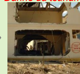
Danno da tsunami
