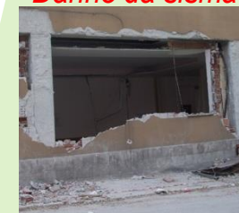
Danno da sisma
